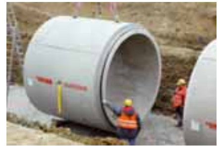
Abb. 4: Die Lieferung der Rohre und Schächte erfolgt durch die Firmen Berding Beton und HABA-Beton
